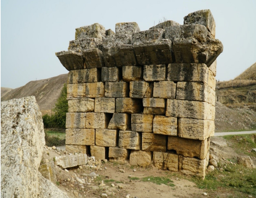
Resim 12: Asopos Köprüsü'nün ayakta kalabilen doğu ayağı kemeri içi korniş sırası ve üstünde kemer başlangıcı, ayaktaki açılmalar ile örgü sistemi.
