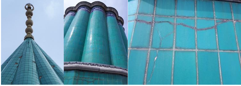
Şekil 5. Kubbe-i Hadra kulak kısmındaki tahribat. Şekil 6-7. Kubbe-i Hadra Taban kısmındaki çatlaklar
