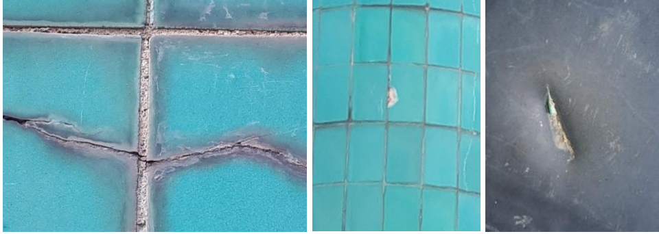
Şekil 8. Kubbe çinilerini birbirine bağlayan harçlarda oluşan çözünme. Şekil 9. Çini parçadaki yüzeyde görülen kopma. Şekil 10. Kurşun sacın kopan çini parçası tarafından delinmesi.
