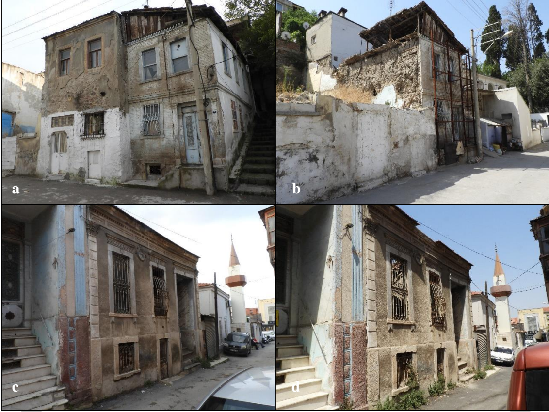
Fotoğraf 2. 113 ada 85 nolu parseldeki yapının 2019(a) ve 2021(b) yıllarındaki fotoğrafları ile 120 ada 52 nolu parseldeki yapının 2019(c) ve 2021(d) yıllarındaki fotoğrafları (Kişisel Arşiv, 2019-2021).
