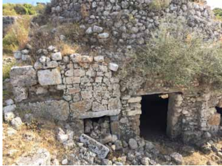
Figür 17. Kapı Etrafında Oluşan Çatlama ve Kırılma, Kuzey Cephe
