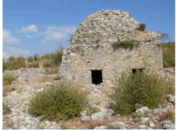
Figür 10. Örgüde Derz Açılmaları ve Çatlaklar, Batı Dış Duvar
