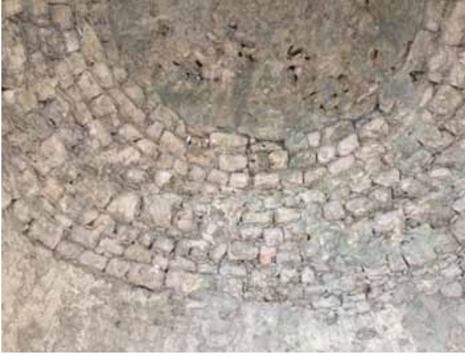
Figür 15. Kubbeye Oluşan Aşınma ve Ufalanma
