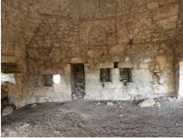
Figür 9. Örgüde Derz Açılmaları ve Çatlaklar, Doğu İç Duvar
