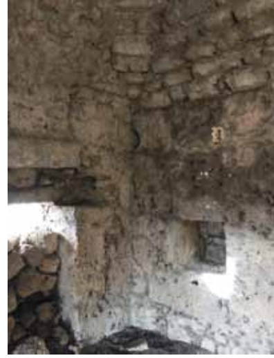
Figür 16. Harim, Güney Doğu Köşe Duvarında Oluşan Aşınma ve Ufalanma
