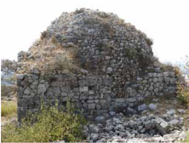
Figür 11. Derz Kayıpları ve Boşalmalar, Doğu Cephe
