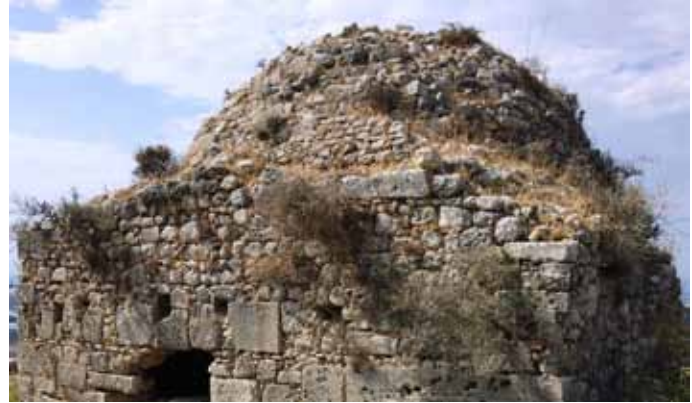
Figür 22. Güney Cephe, Üst Bölümünde Oluşan Bitkiler
