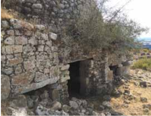
Figür 21. Kuzey Cephe, Giriş Kapısı Üst Bölümünde Oluşan Bitkiler
