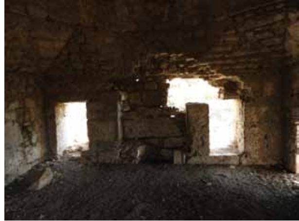
Figür 8. Mihrap Örgü ve Birim Malzeme Kayıpları, Güney Cephe
