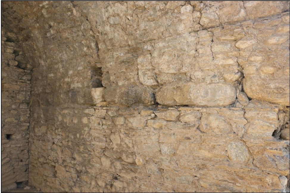
Resim 20. Yapı Duvar ve Tonozlarda Görülen Çatlamalar.
