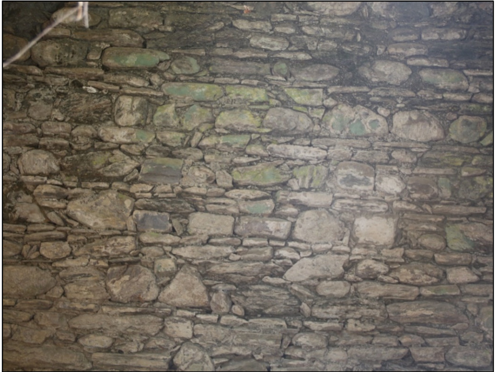
Resim 18. Güney İç Cephe, Duvar Örgülerinde Görülen Çatlama ve Derz Bozulmaları.
