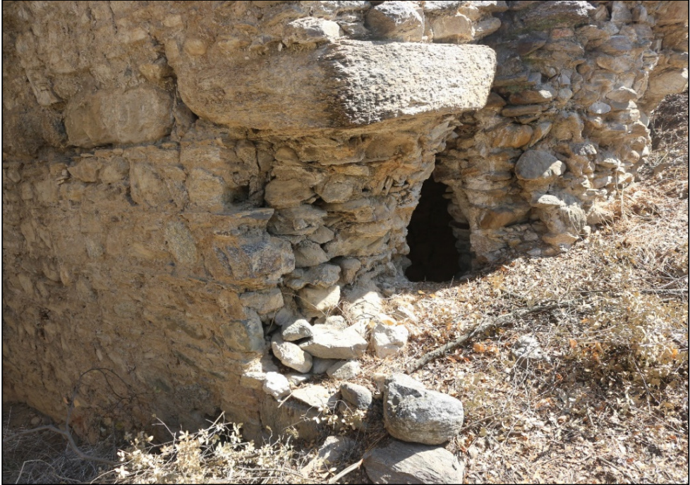
Resim 16. Güney Dış Cephe, Geniş ve Dar Örgü Alanlarında Görülen Birim Malzeme Kayıpları.
