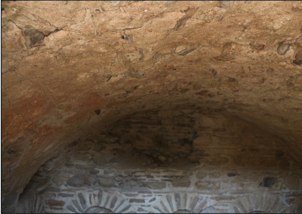
Resim 14. Yapı Duvarlarında Kullanılan Sıva Malzeme Kalıntıları.
