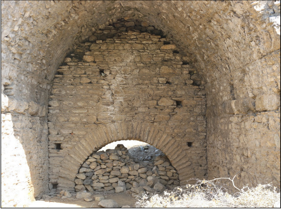
Resim 25. Güney Dış Cephe Tonoz Duvarındaki Tuz Çıkışları.
