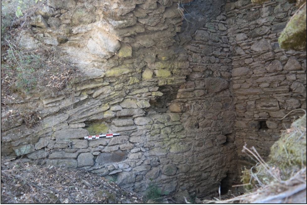
Resim 17. Güney İç Cephe, Duvar Örgülerinde Görülen Çatlama ve Derz Bozulmaları.
