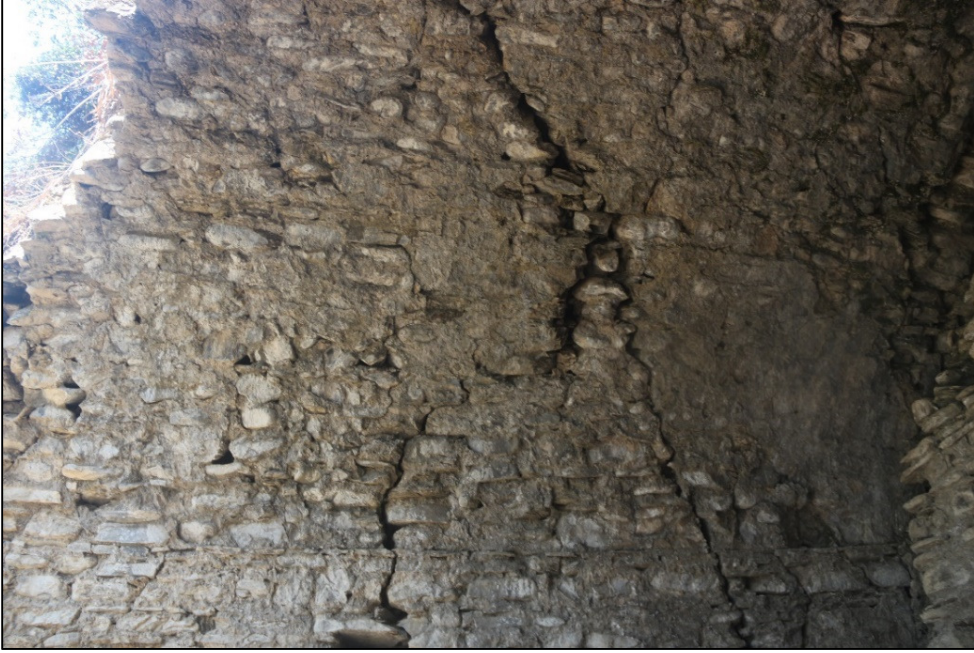
Resim 19. Yapı Duvar ve Tonozlarda Görülen Çatlamalar.
