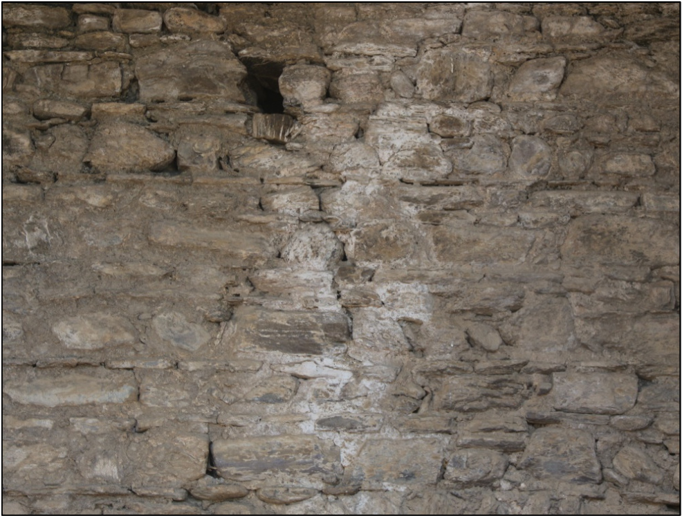
Resim 26. Güney Dış Cephe Tonoz Duvarındaki Tuz Çıkışları.
