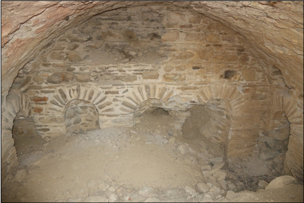
Resim 28. Güney Dış Cephe Tonozlu Mekanlarda Yapılmış Olan Kaçak Kazılar.
