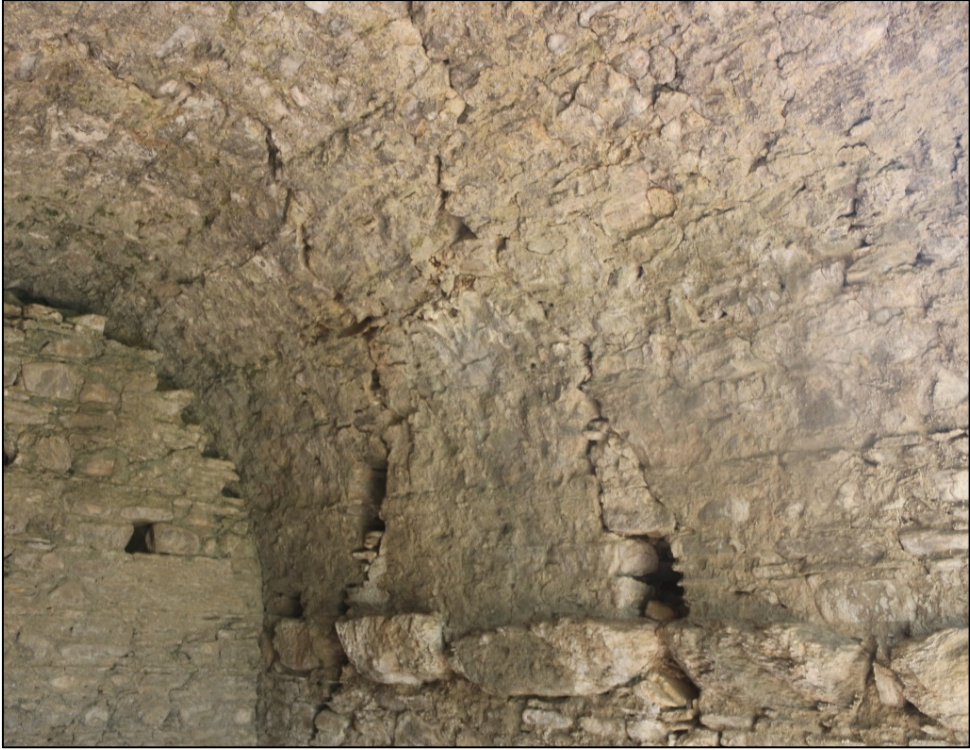
Resim 13. Yapı Duvarlarında Kullanılan Sıva Malzeme Kalıntıları.
