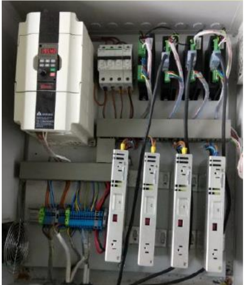
Şekil 3.34: Kontrol panosu genel görünüm
