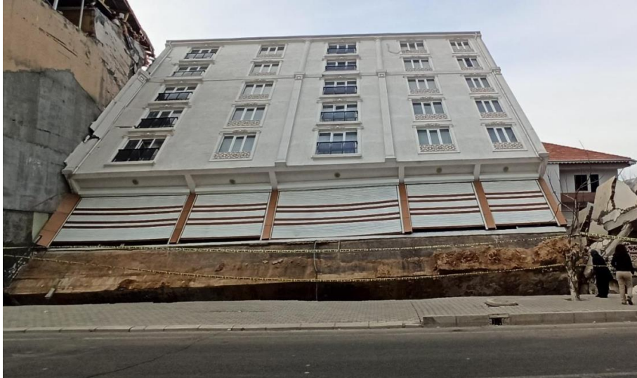
Şekil 3.3: 2023 Kahramanmaraş Depremi nedeniyle meydana gelen sıvılaşma sonucu binanın geriye doğru devrilmesi (MTA, 2023).
