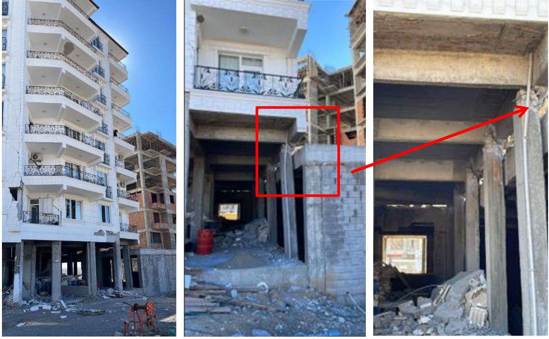
Şekil 4.3. Farklı kat seviyelerine sahip komşu binalar arasında gözlenen kesme göçmesi (Kahramanmaraş Depremleri, 2023)
