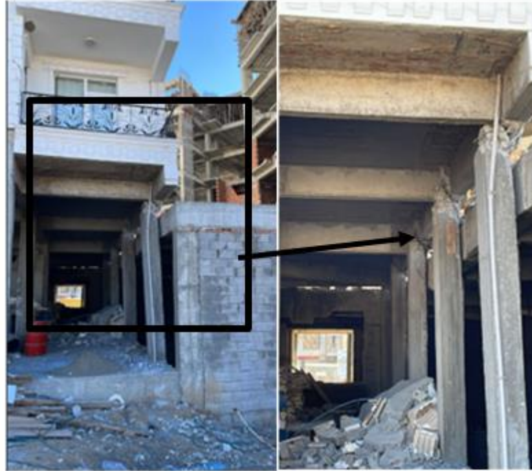
Şekil 1.1: Deprem Sonucunda Çekiçleme Etkisinden Dolayı Meydana Gelen Yapı Hasarı (Kahramanmaraş, 2023)
