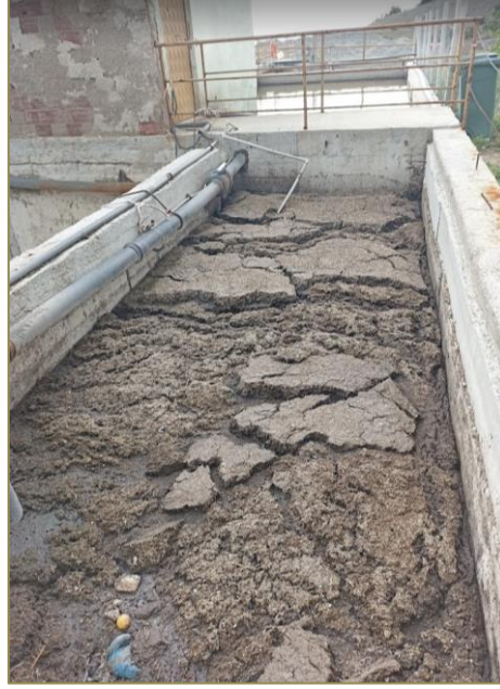
Şekil 4.1: Yoğun hayvansal atıksu girişi nedeniyle tıkanan kırsal arıtma tesisine ait giriş kanalı (DESKİ, 2023)
