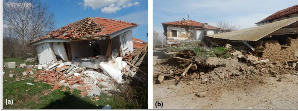
Şekil 7.15: Kırca mahallesinde delikli tuğla ile yapılmış tek katlı binadaki ağır hasar ve tamamen yıkılmış kerpiç yapı.
