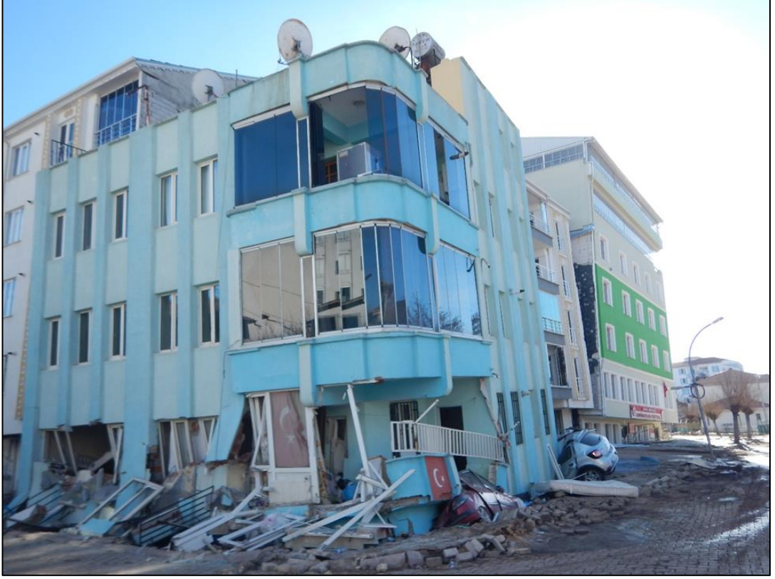
Şekil 7.3: 6 Şubat 2023 Kahramanmaraş depremlerinde sıvılaştan zemindeki kabarmalar ve oturmalar, binalardaki zemine gömülmeler, düşeyden sapsmalar ve yapısal hasarlar (resim Halil Kumsar'dan alınmıştır)
