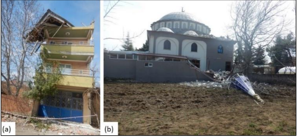
Şekil 7.16: a) Oğuz mahallesinde betonarme binanın delikli tuğla ile yapılmış çatı katındaki ağır hasar, b) Ağır hasarlı yığma cami binası ve devrilmiş minaresi.
