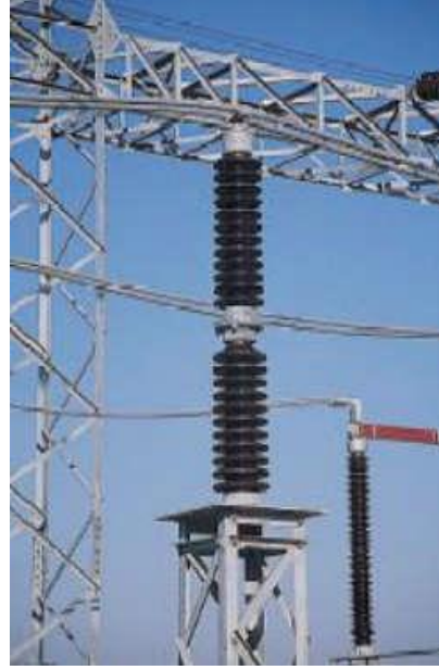
(a) Harici mesnet izolatörleri
