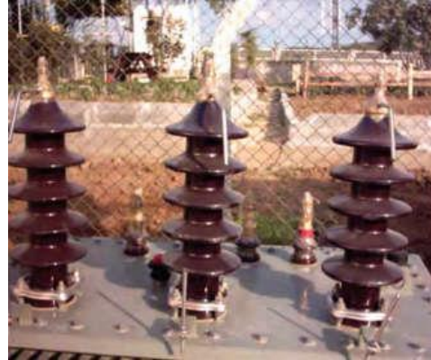
(d) Buşing izolatörleri
