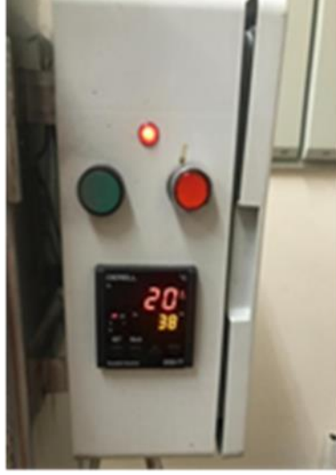
Şekil 2.4: Vakum fermantasyon cihazı kontrol paneli.
