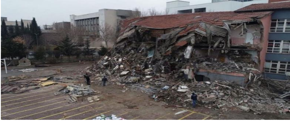
Şekil 1.2: Bingöl Depremi-Çeltik suyu Yatılı İlköğretim Bölge Ortaokulu
