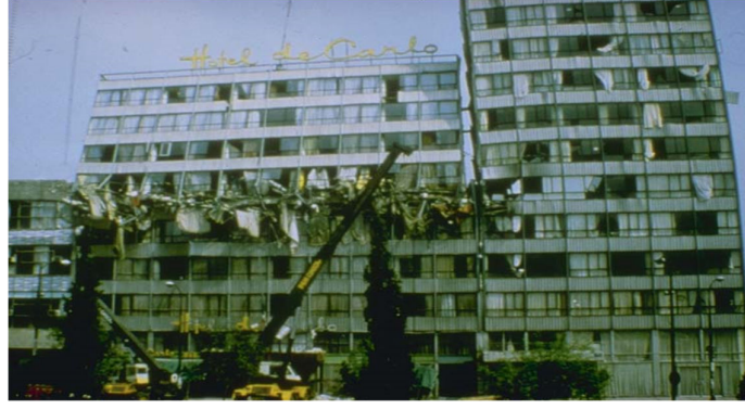
Şekil 1.2: 1985 Mexico City Depremi Sonrası Yetersiz Deprem Derzi Nedeniyle Görülen Çekiçleme Hasarı (Arnold, 1989)
