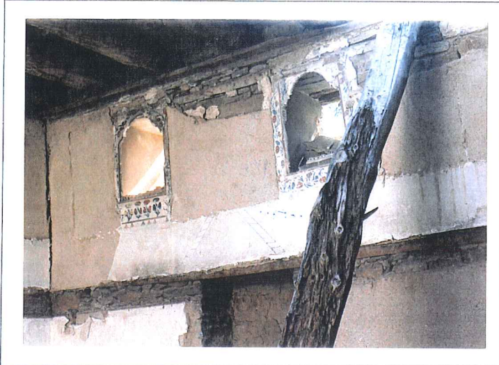
3.4.33. Yıkılan Odanın Pencereleri
