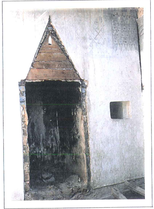
3.4.29. Yıkılan Odanın Ocađı
