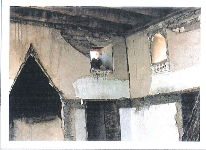
3.4.32. Yıkılan Odadaki Ocağın Sağ Cephesi
