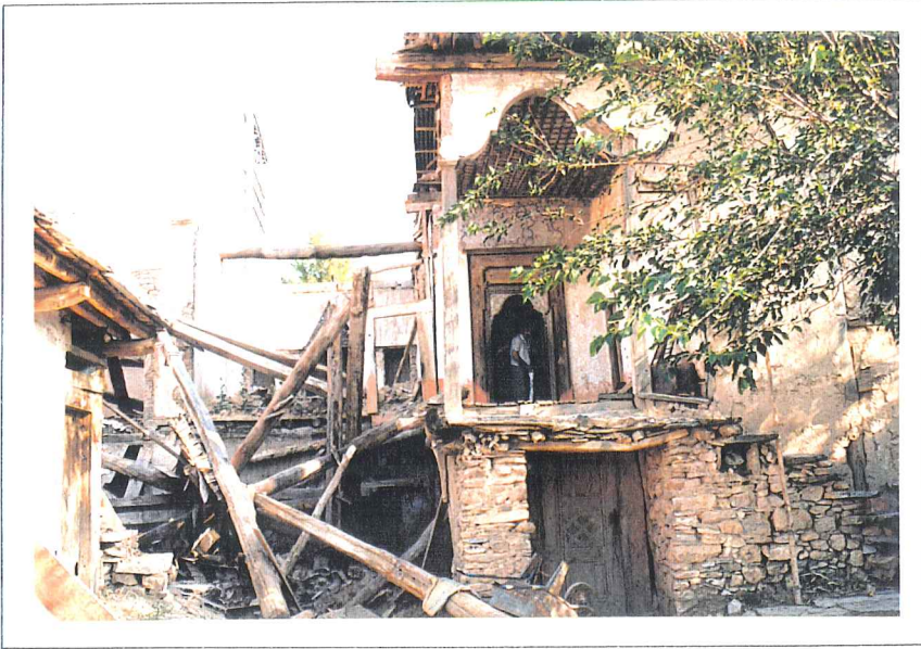
3.4.8. Yapının Yıkılan Kısımından Genel Görünüş
