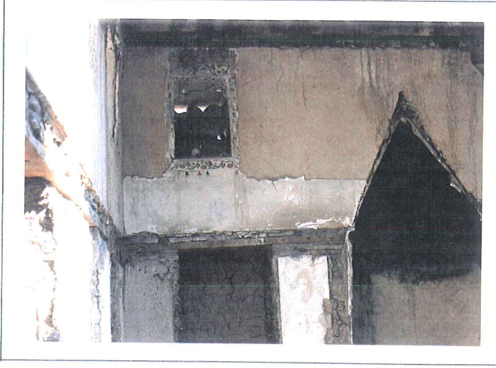
3.4.31. Yıkılan Odadaki Ocağın Sol Cephesi
