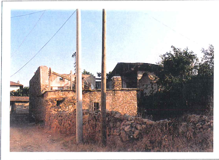
3.4.3. Dış Cephesinden Yıkılan Tarafın Genel Görünüşü
