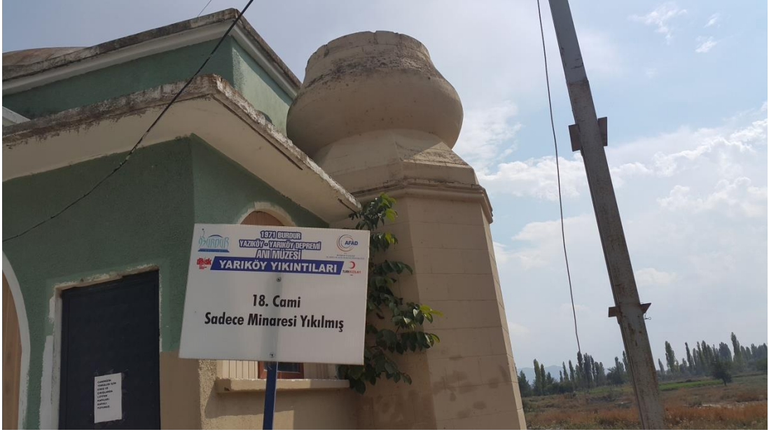
Şekil 5.18: 12 Mayıs 1971 saat 08.25’de meydana gelen 5.9 büyüklüğündeki depremde gerçekleşen Yarıklı yıkıntılarında bir tanesi.
