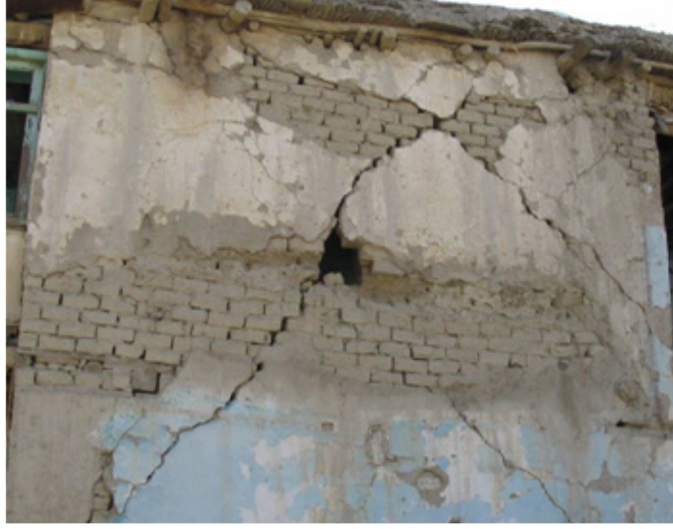
Sekil 1.4 Yigma duvarda egik çatlama (Kaynak: S. Korkmaz arsivi)
