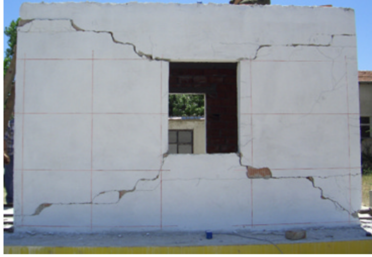
Sekil 1.6 Duvarda bosluk bulunmasi durumunda egik çatlak (Altin, 2005)
