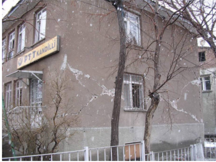
Sekil 1.5 Uzun yigma duvarda egik çatlama (Kaynak: A. Türer arsivi)
