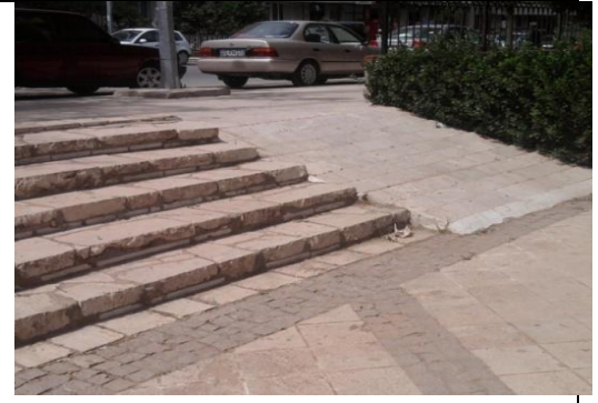
Korkuluksuz Rampa ve Merdiven (20)
