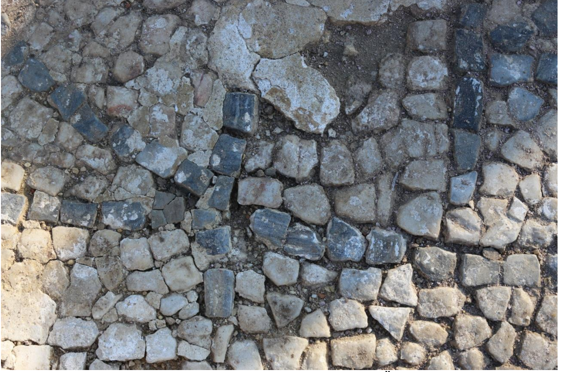
Figür 32: 5 Nolu Panel Derz Bozulması Örneđi
