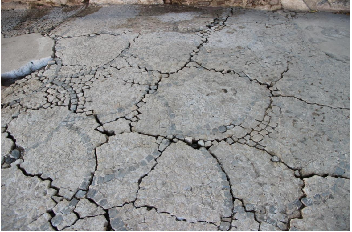
Figür 20: 2 Nolu Panel Çatlama Örneği
