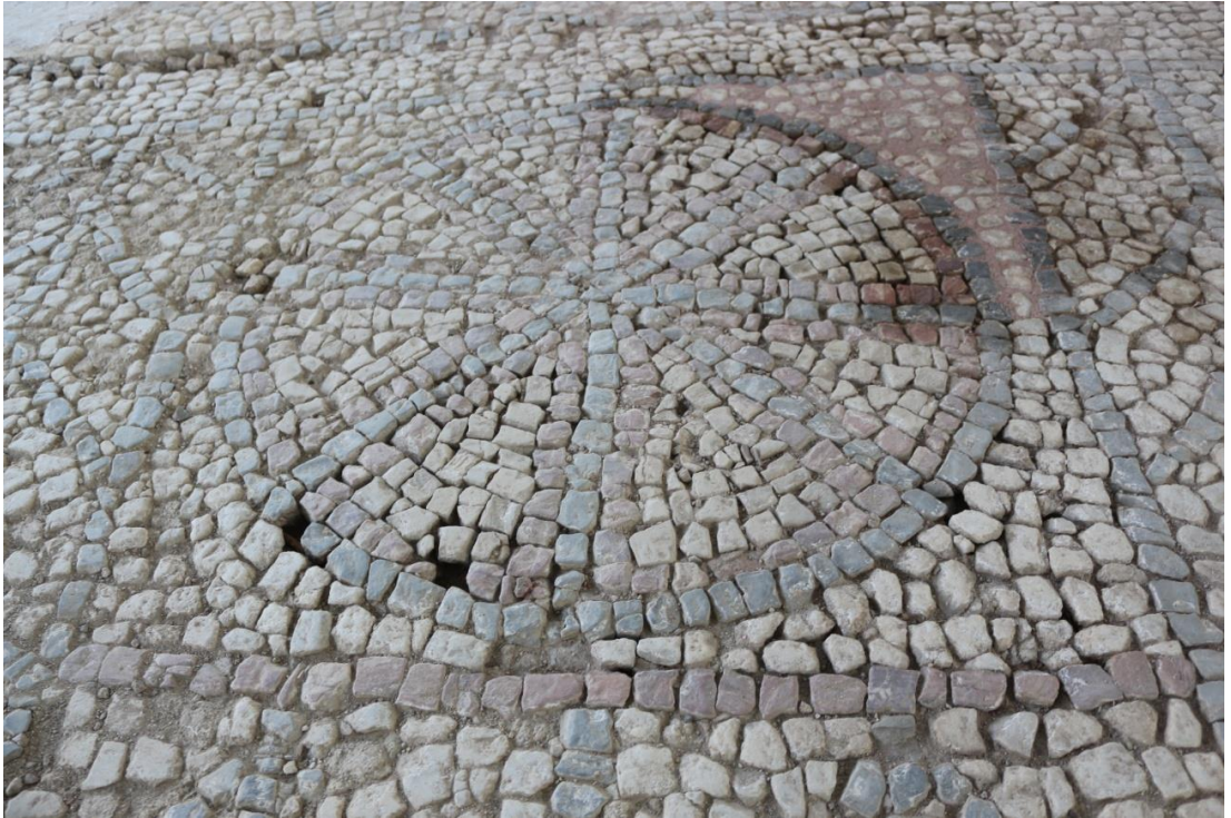
Figür 25: 5 Nolu Panel Derz Bozulması Örneđi
