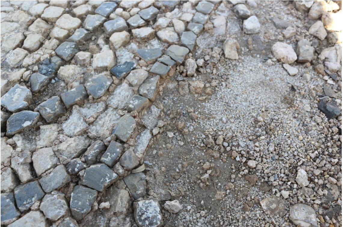
Figür 27: 5 Nolu Panel Tessera Bozulması (Ufalanma) Örneđi
