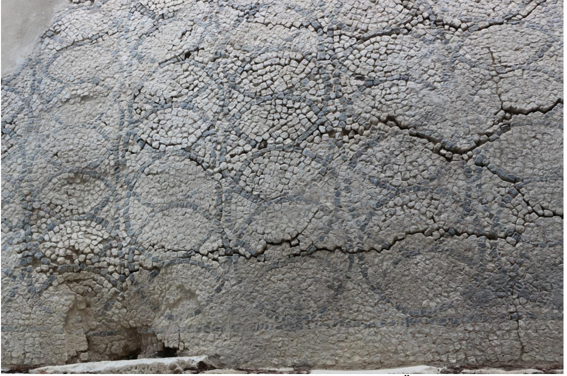
Figür 22: 3 Nolu Panel Çökme ve Yükselme Örneği
