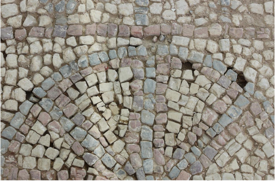
Figür 26: 5 Nolu Panel Tessera Bozulması (Kırılma) Örneđi
