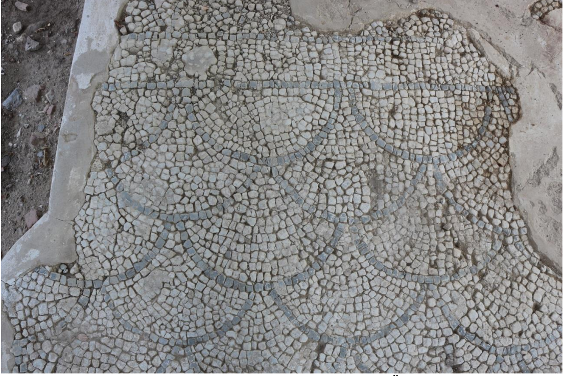
Figür 24: 6 Nolu Panel Derz Bozulması Örneđi
